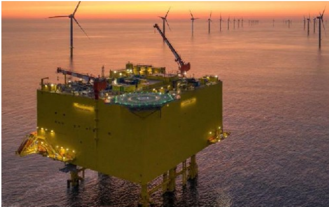
Exemple de poste électrique en mer (BorWin 3, Crédit image Siemens)
