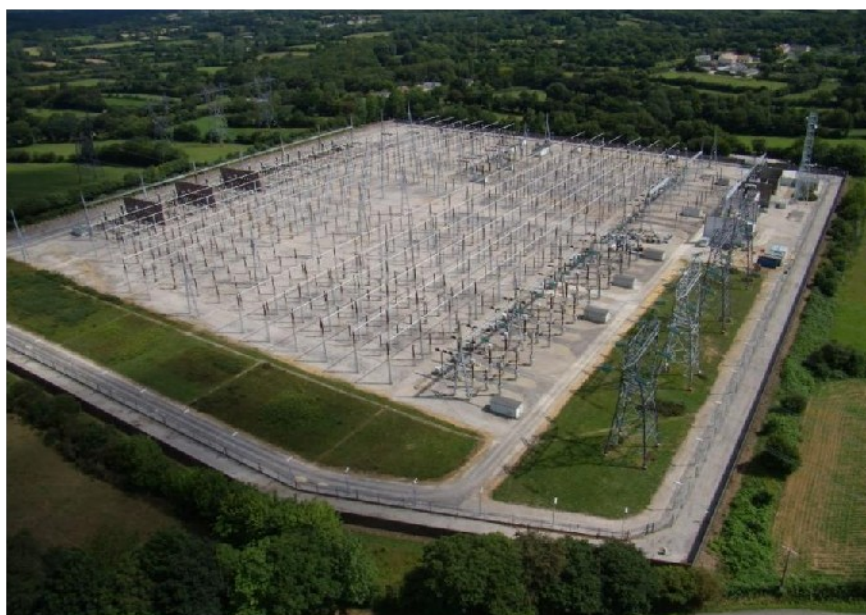
Vue aérienne d'un poste 400 000 Volts (Menuel, à l'Etang Bertrand) (Crédit photos Rte)
