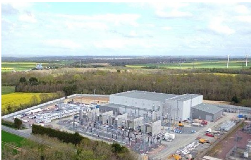
Exemple d'une station de conversion 320 kV continu / 400 kV alternatif (Crédit photo Rte)
