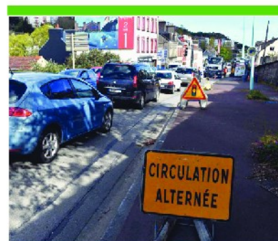
→ Des travaux sur le réseau électrique jusqu'au 28 mai avenue de Paris imposent une circulation alternée.
