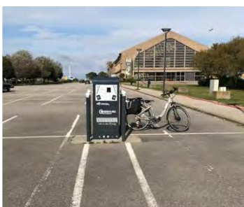
Bornes de recharge électrique Type Ville
