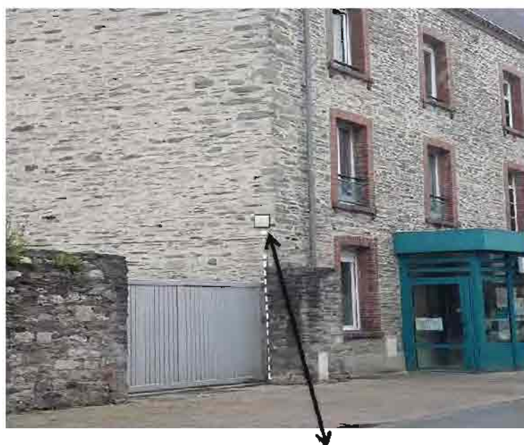
Pose d'un BPO prévue sur la partie du RDC ville de Cherbourg-en-Cotentin
