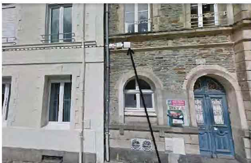
Pose d'un BPO prévue sur la façade de l'immeuble 22 rue de la Bucaille
